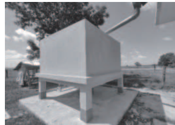
③新設された給水タンク
